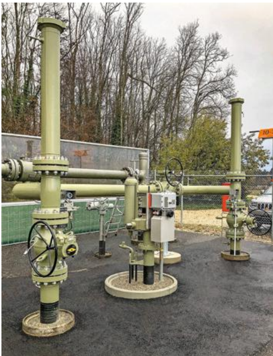
Station de sectionnement entièrement rénovée
