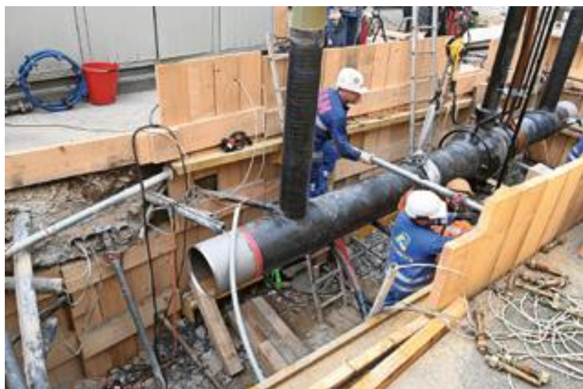
... et l'installation selon des normes de sécurité sévères
